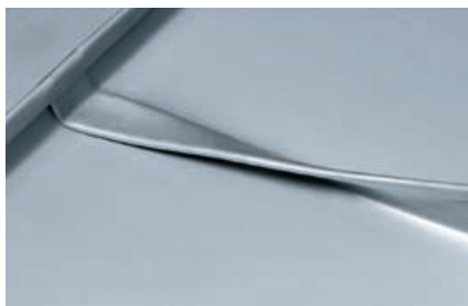
Закругленное фальцевое соединение (1а) высота > 150 мм Фальц в продольном направлении (двойной стоячий фальц)
